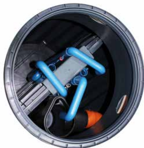
Fertig montierter airlift.blue mit Domschacht
